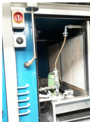
Impianti RVC a valle del loro interruttore principale
